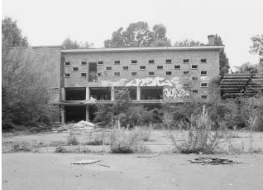
De voormalige school is momenteel nog een ruïne. Hier komen tegen de zomer van 2004 sociale woningen.
